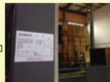
◀東大阪倉庫 2階リフター 操作盤横
